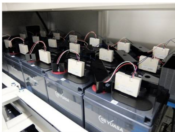
各蓄電池へのセンサユニット設置例
