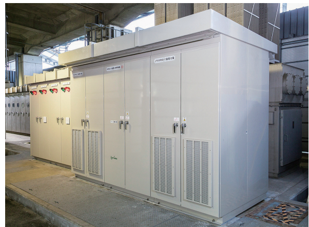
2. 回生電力貯蔵装置「非常走行蓄電池部」
