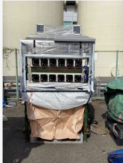
脱水汚泥乾燥機
