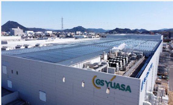
太陽光発電設備
