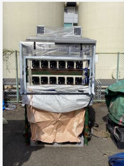
脱水汚泥乾燥機
