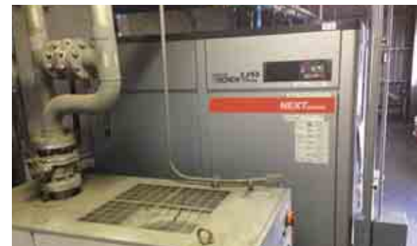
コンプレッサー
