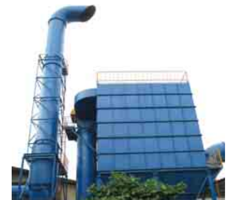
改修した集じん機
