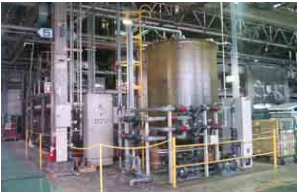
水の循環利用設備(長田野)
