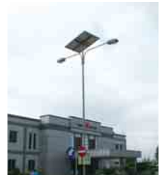
事務所近辺の照明機器
