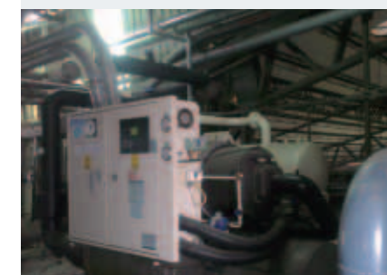
省エネに向け導入した空調設備
