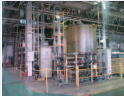
水の循環利用設備
