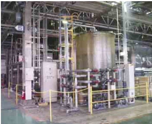
冷却水循環設備
