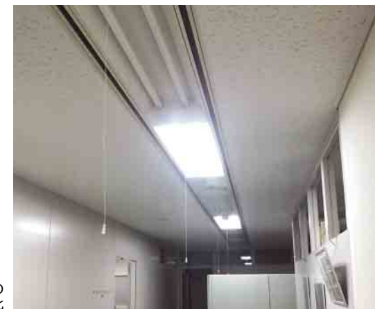
天井照明の個別消灯化
