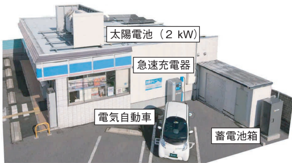
図7 実証試験システムの設置状況
