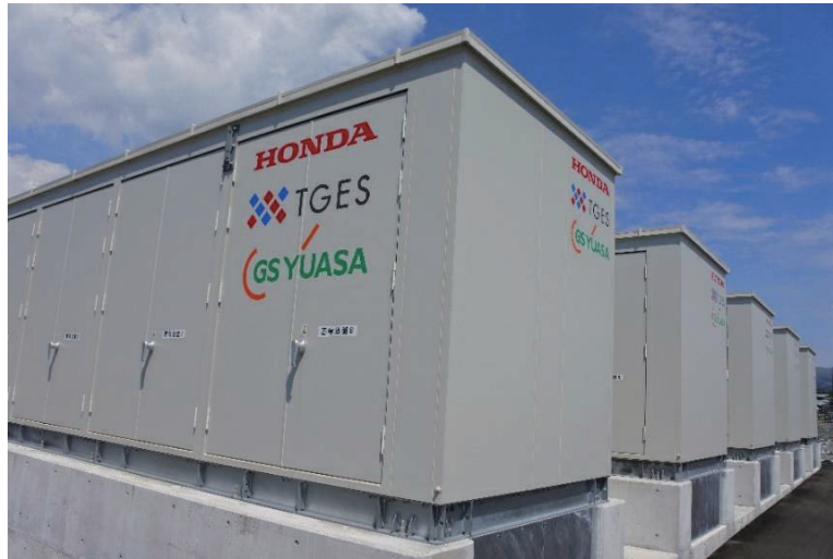
①リチウムイオン蓄電池システム
