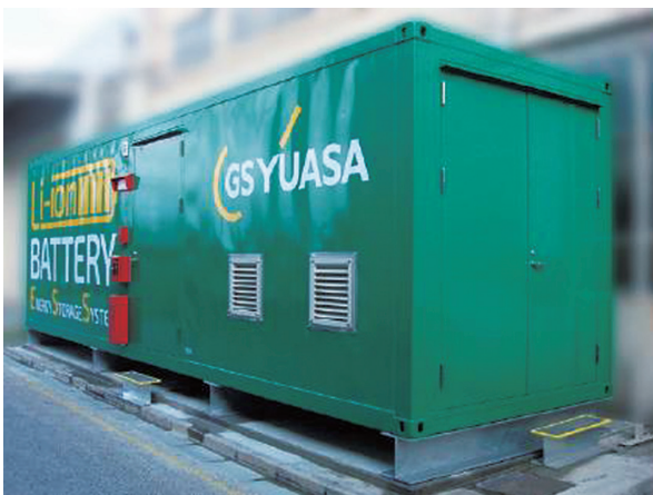
図1 コンテナ式電力貯蔵装置の外観
