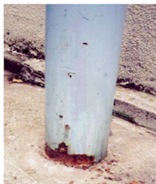
▲ 地際部 犬の尿により錆びた状態
