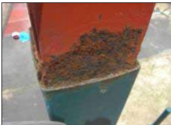
ポールアダプター部が錆びた状態
