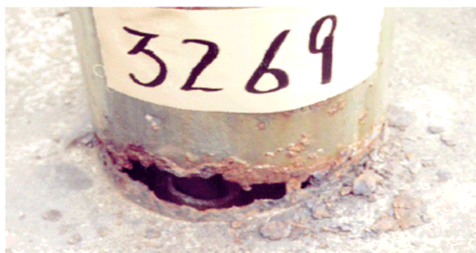
▲ 地際部が錆び、孔が開いた状態
