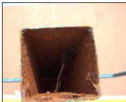
ポールアダプター部が腐食消失した状態
