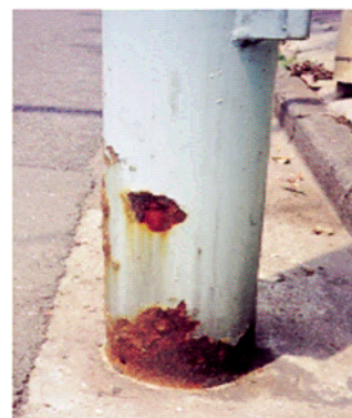
▲ 地際部 犬の尿により錆びた状態
